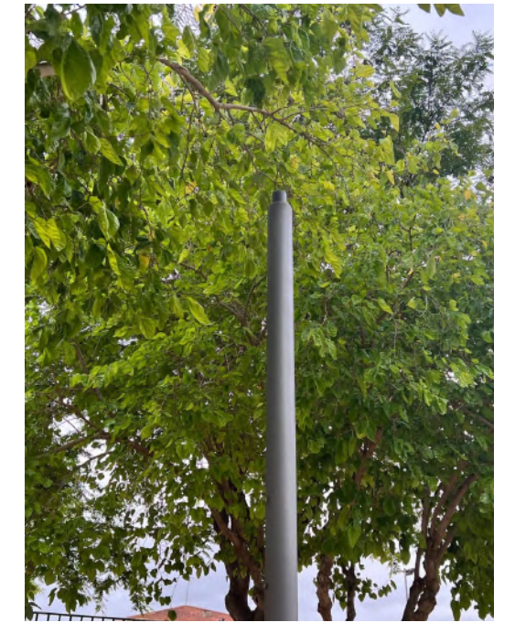
Parque colegio: Iluminación
